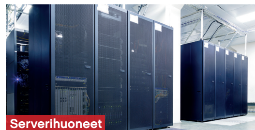
Sähkö- ja laitetilat
