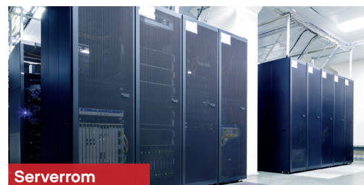
Elektro- og maskinrom
