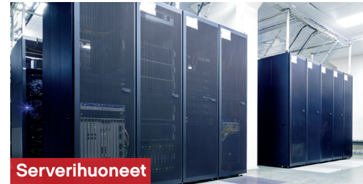
Sähkö- ja laitetilat
